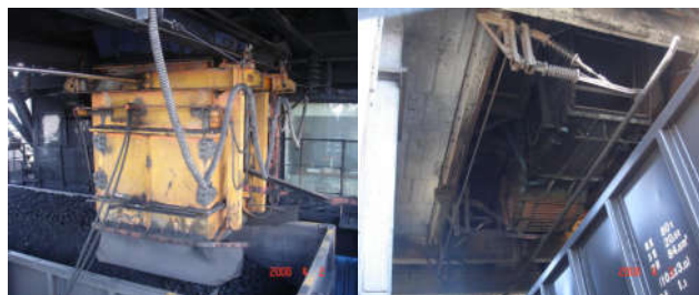
图1.3 煤炭装载设施
