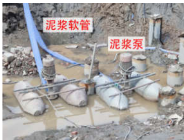
(b) 泥浆软管和泥浆泵
