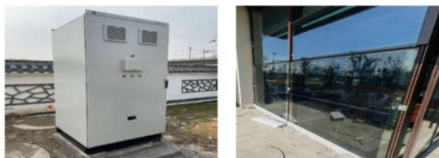
图3 储能柜、BIPV现场实拍图
