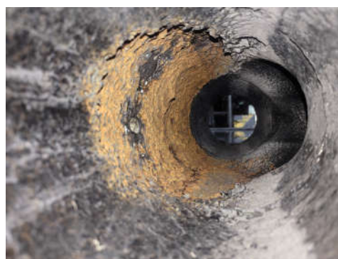
图二 锁斗循环泵出口管线冲刷后情况
