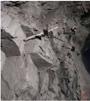
图1 锚杆悬空失效
