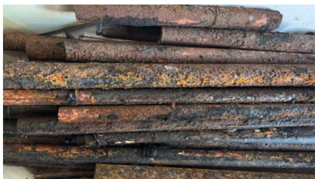
图 1 大楼空调水系统更换下来的水管
