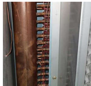
图2 防冻开关错误安装
