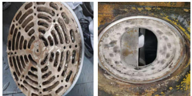
图1 压缩机3级进气阀堵塞 图2 压缩机3级进气阀堵塞
