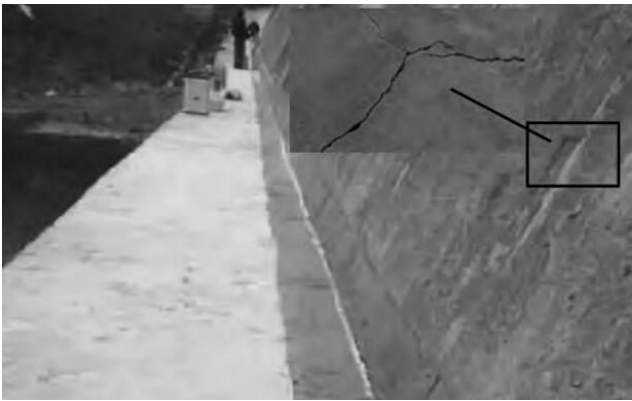
图1 某水利项目混凝土裂缝
