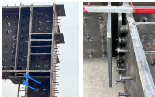
图5、图6钢筋搭接板间隙小
