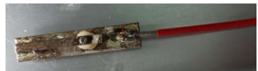
图4 接线柱锈蚀图
