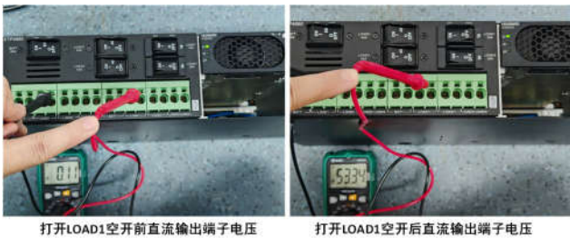
图3 未安装监控模块时ETP4890备件LOAD1空开打开前后直流输出端子电压值示意图
