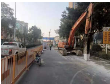
图1 施工设备随意放置
