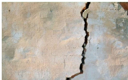
钢筋混凝土结构裂缝如图一所示
