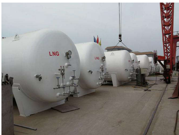
LNG储罐液化天然气储罐如图1所示
