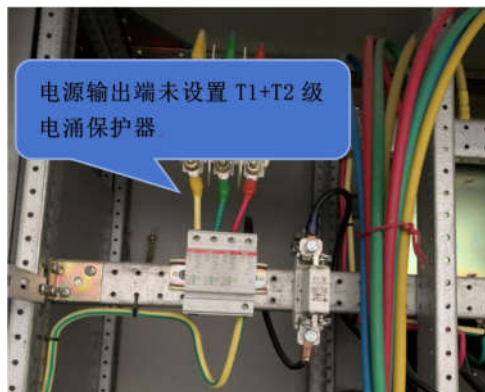
图2 原水水质间1号抽屉式低压开关柜
