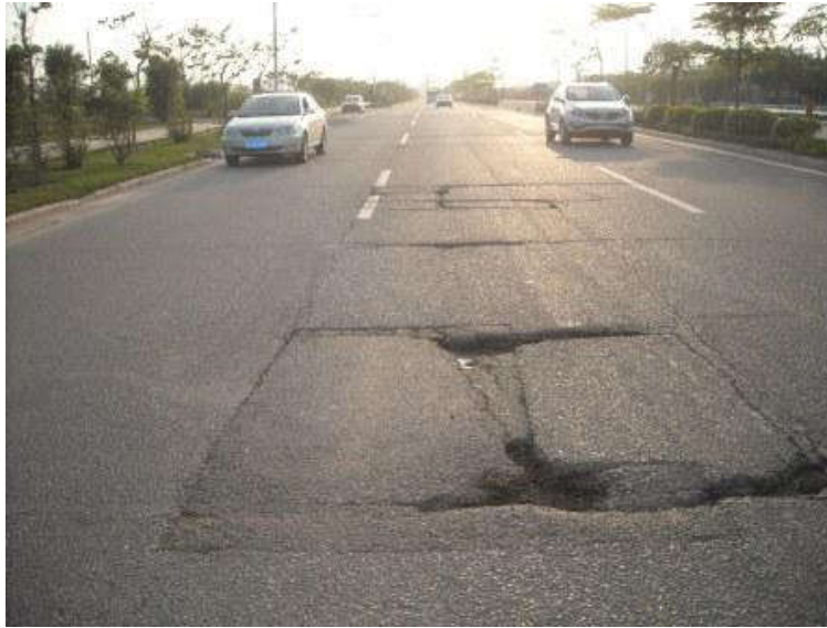
图3 裂缝问题扩散
