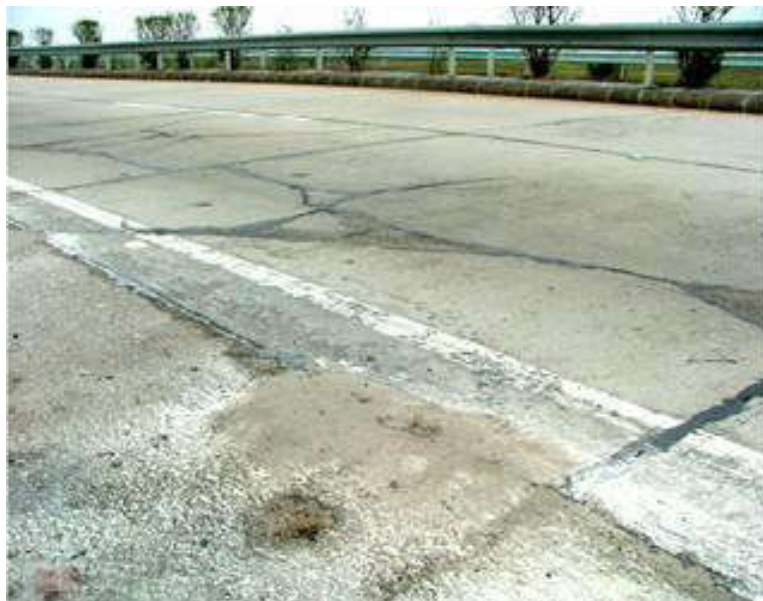
图2 裂缝问题出现
