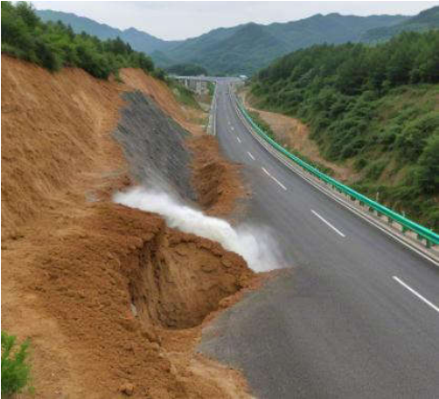
图4 高速公路滑坡勘察背景图
