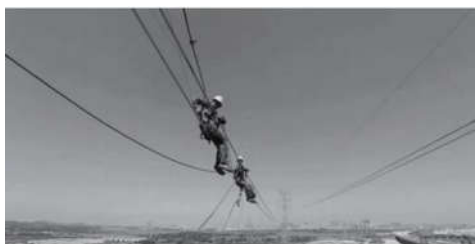
图1 输电线路监测维修
