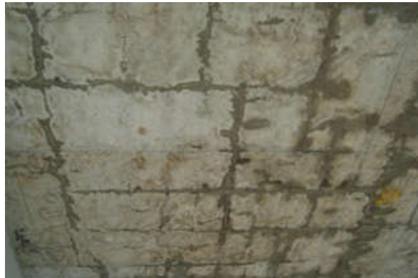
图1 水化热导致裂缝
