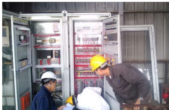
图2 燃烧器厂家现场调试图
