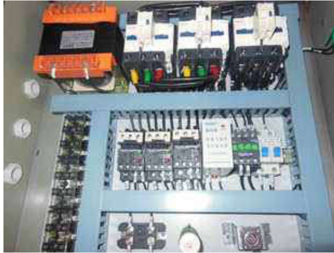
图1 工业电气控制柜
