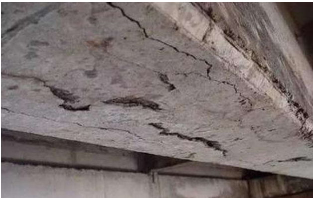
混凝土桥梁的常见病害如图所示
