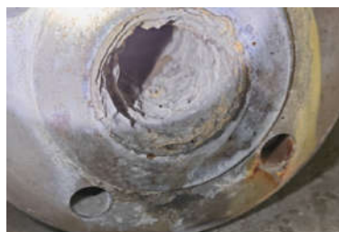
冷冻水分布器结垢严重 图01 “空冷塔冷冻水分布器”
