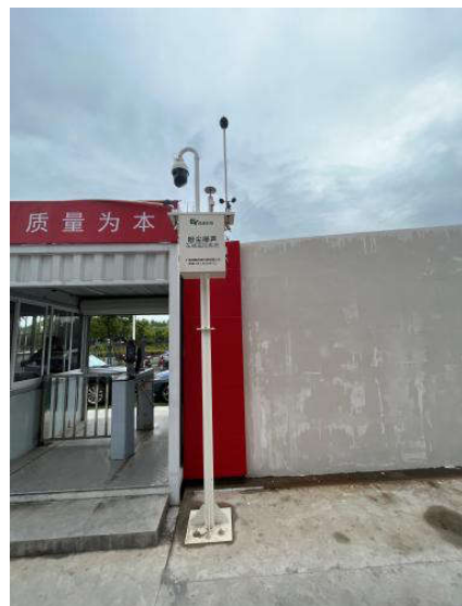
图5 扬尘监控系统
