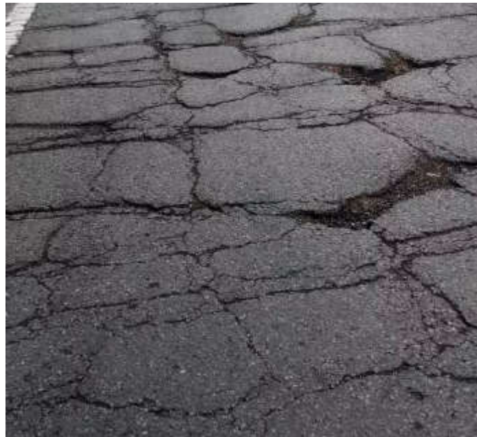
图1 公路裂缝病害
