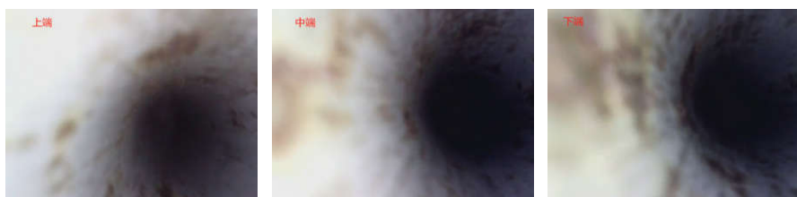
图1 不同位置氮气管道内部锈蚀情况
