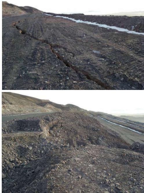
图3 黑山煤矿采掘场北帮边坡局部台阶开裂及失稳现象
