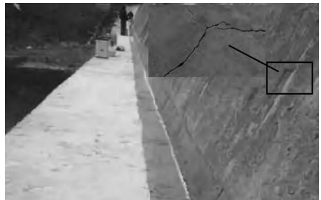
图1 某水利项目混凝土裂缝
