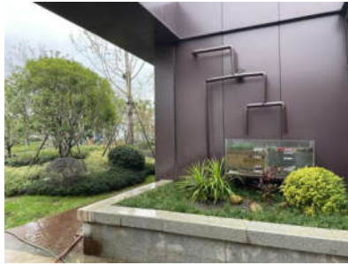
△节点屋顶海绵雨水再利用
