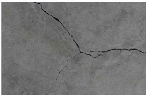
图1 混凝土裂缝问题
