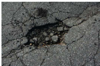
图2 沥青路面破损
