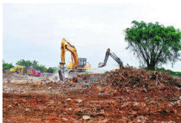
图1 施工对植被的破坏
