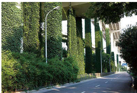
图1 高架桥墩上的立体绿化设计
