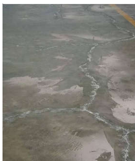
图3 裂缝后期修补
