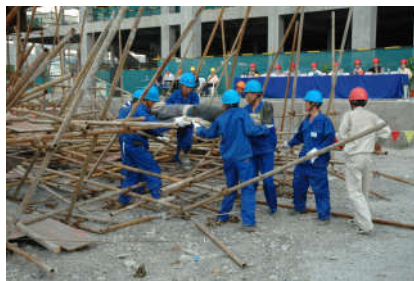
图1 施工现场发生安全事故
