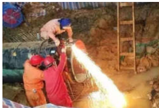
图1 施工过程中未做好相应的安全防护措施
