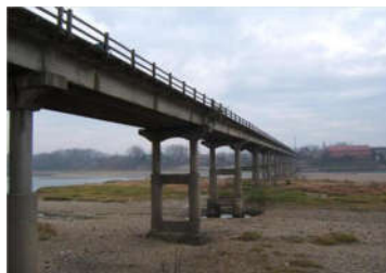
图1 桥梁结构受损
