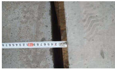
图2 桥梁路面连接处质量问题
