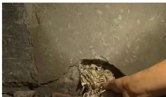
图3 墙体质量不合格出现豆腐渣工程
