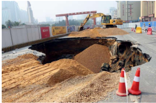
图1 路面塌陷事故
