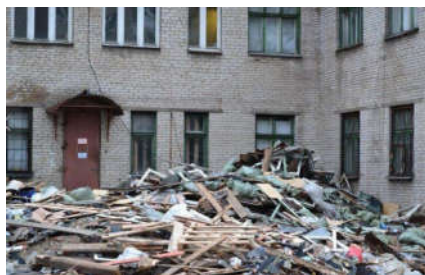
图1 某建筑项目建筑垃圾现场情况
