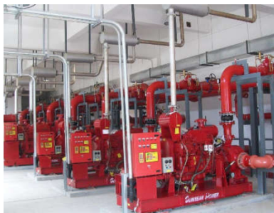
图1 消防给排水系统管道
