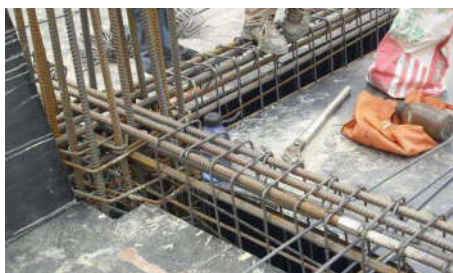
图1 不规范的钢筋捆绑操作
