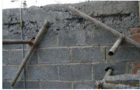
图2 混凝土材料导致空洞、漏筋问题
