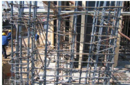
图3 钢筋结构绑扎不规范
