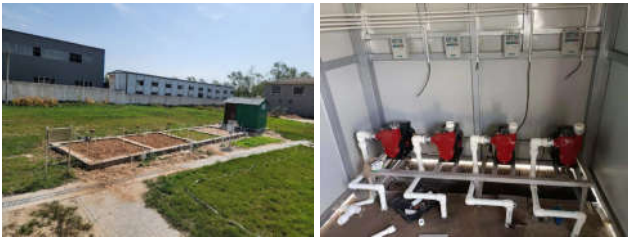
灌溉样方试验区全貌及灌溉控制室抽水设备装置
