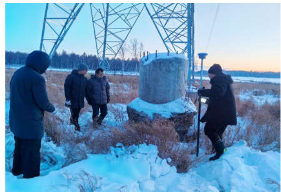
图3 黑河地区电力线路工程桩基冻拔图(拍摄于2023.12)
