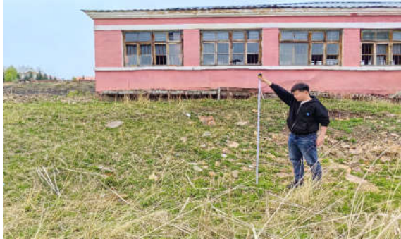
图2 内蒙古伊图里河镇冻土融化沉降(拍摄于2024.05)
