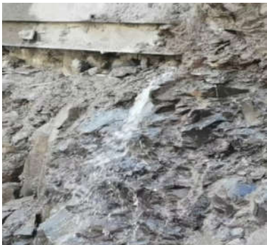
图4 渗漏点开挖出现渗漏水
