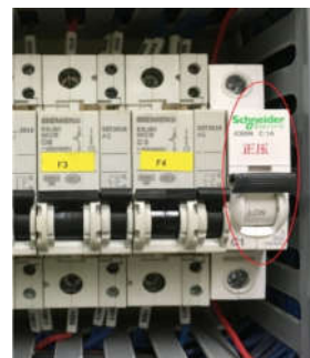
图5 压缩空气控制阀门断路器
