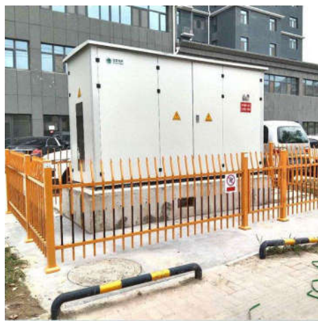
居民区配电变压器如图二所示
