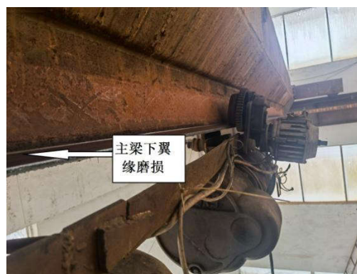
图2 主梁工字钢下翼缘磨损
