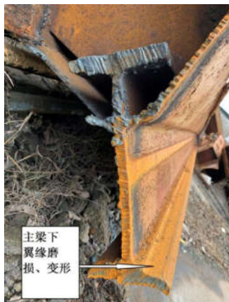
图3 主梁工字钢下翼缘磨损变形
