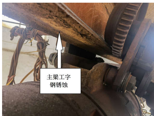
图1 主梁工字钢锈蚀
