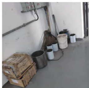
图2 电梯机房内堆放杂物
