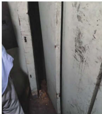
图3 轿厢门严重变形
